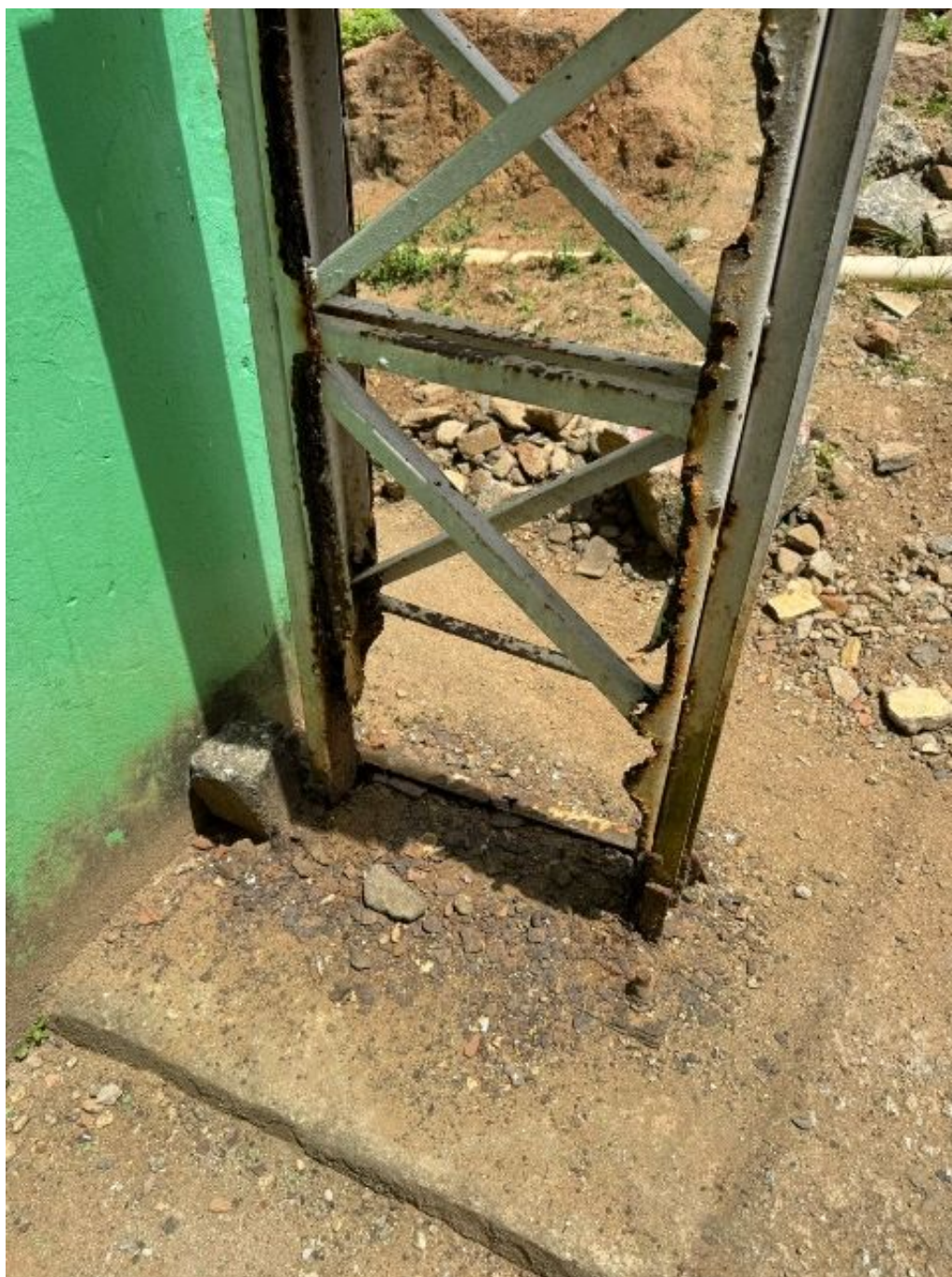
Pilar metálico com corrosão severa na base;
