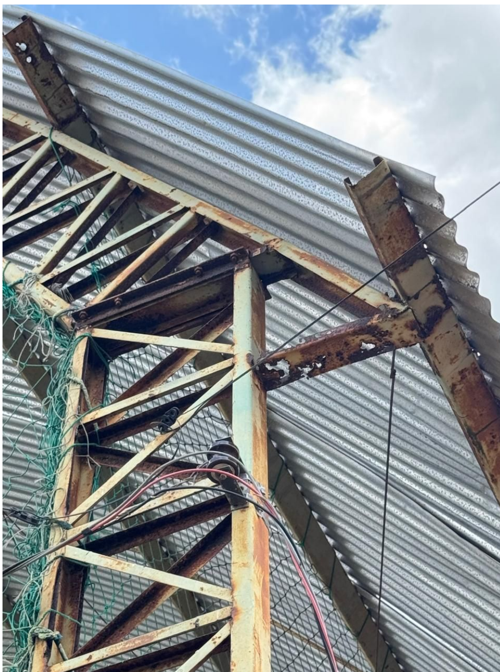
Fios elétricos instalados de forma irregular;
