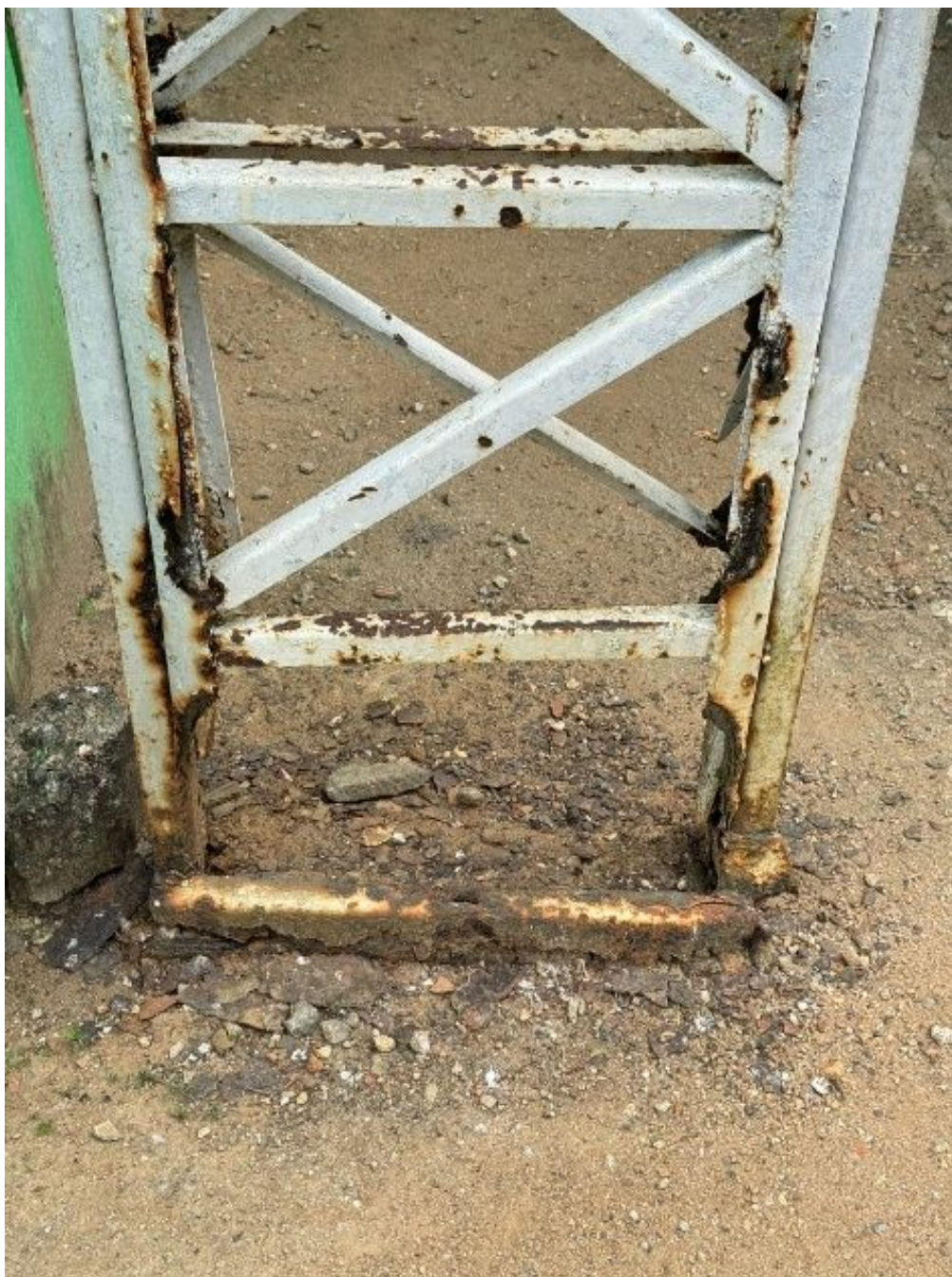
Base de pilar com grave corrosão;
